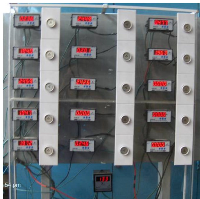
Figura 1.21. Tablero de control de corriente y voltaje.
